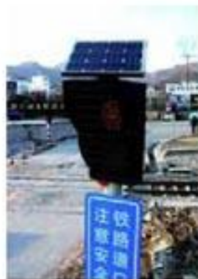
图4.3-3 太阳电池供电的信号灯。可以看到，这个供电组件是由许多单片硅太阳电池组成的。
