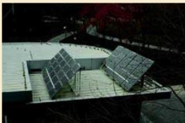
图4.5-1 北京万寿公园的光伏电站
