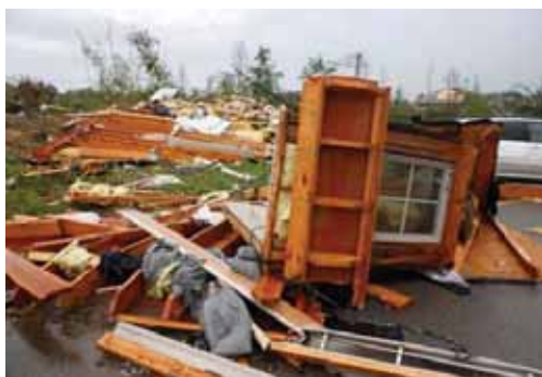
被龙卷风破坏的房屋
